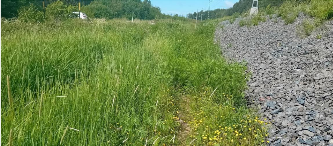
Kuva 11 Kappelinsalmen heinäkasvien peittämä radanvieri.
